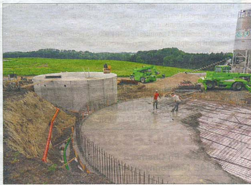
La préfosse où sont déversés les déchets et le digesteur. Photos MC
